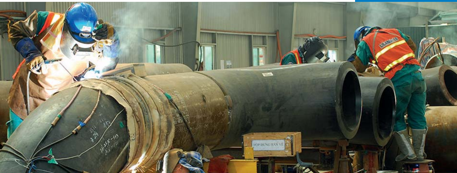
Chế tạo ống áp lực cho nhà máy nhiệt điện Fabrication of pressure piping for thermal power plants
